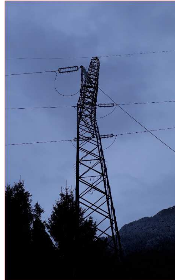
Immagini di sradicamenti piante e danni alle linee elettriche nella Valle del Lys
