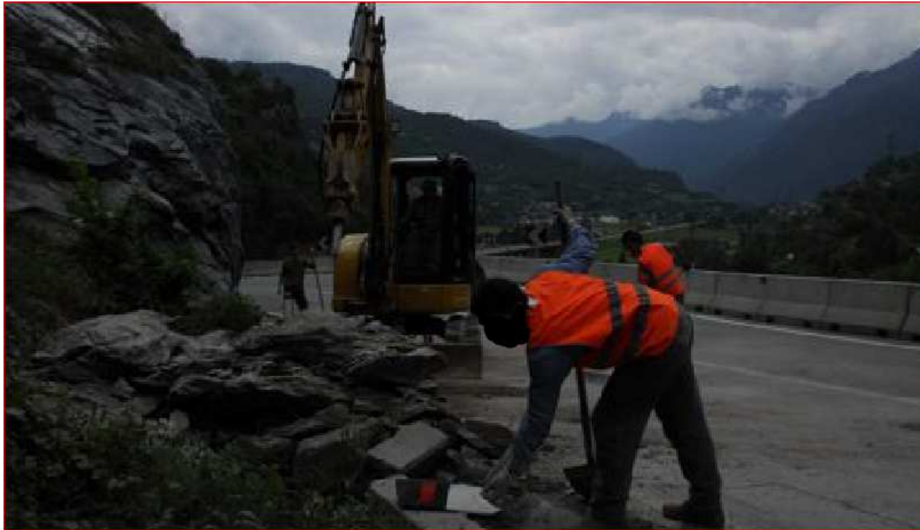
Interruzione della SS 26 in Comune di Monjovet
